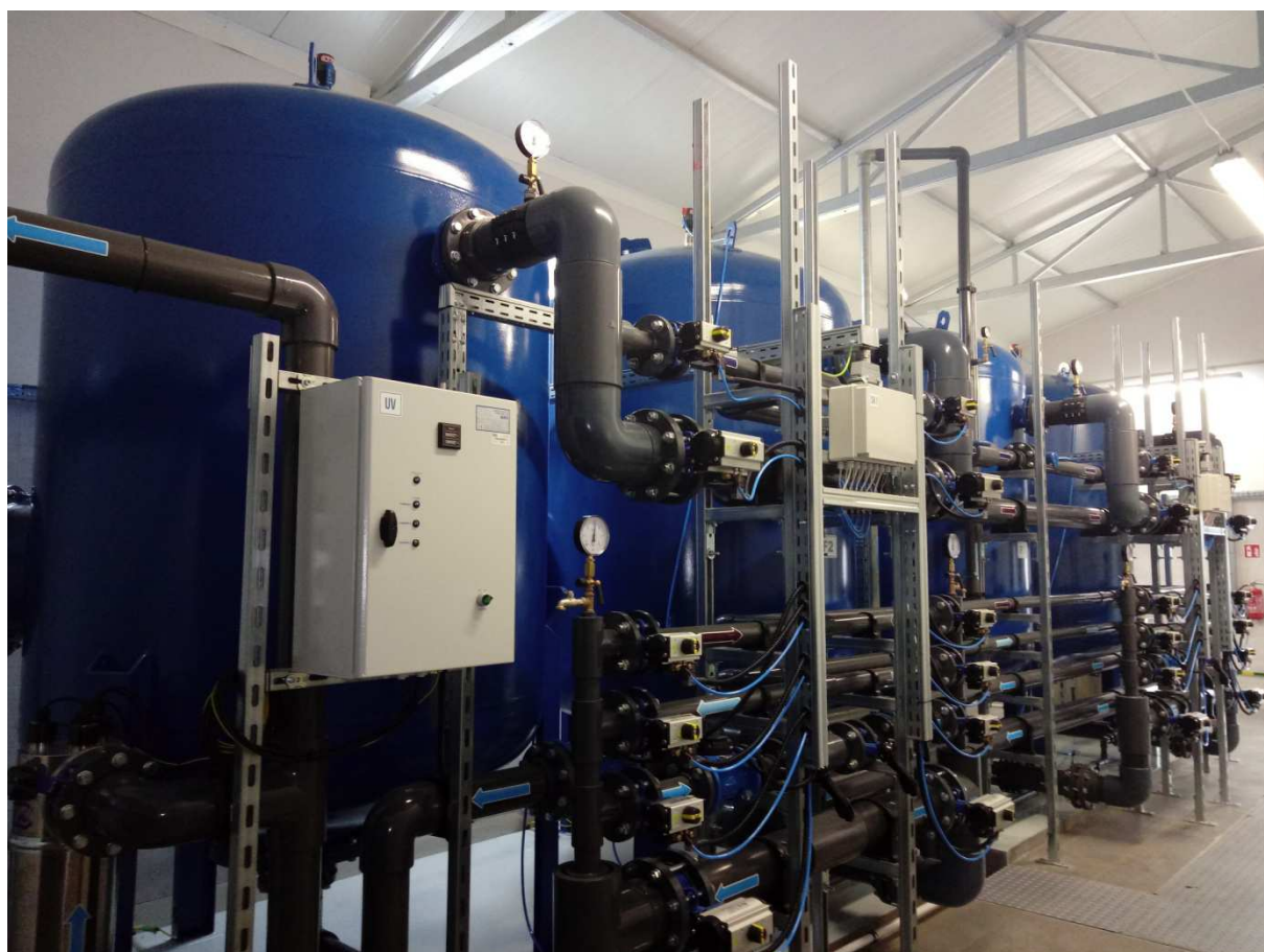
Rysunek 3. Stacja uzdatniania wody w Cielądzu – I etap realizacji umowy w ramach dofinansowania EFR na rzecz Rozwoju Obszarów Wiejskich na lata 2014-2020.
